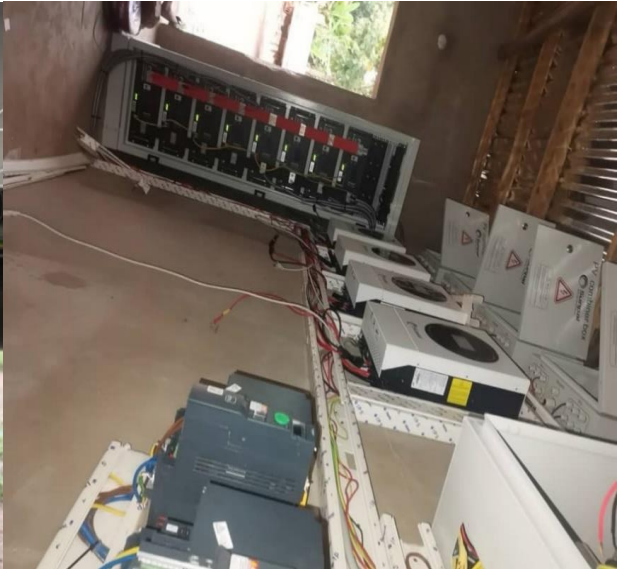
Connexion des batteries
