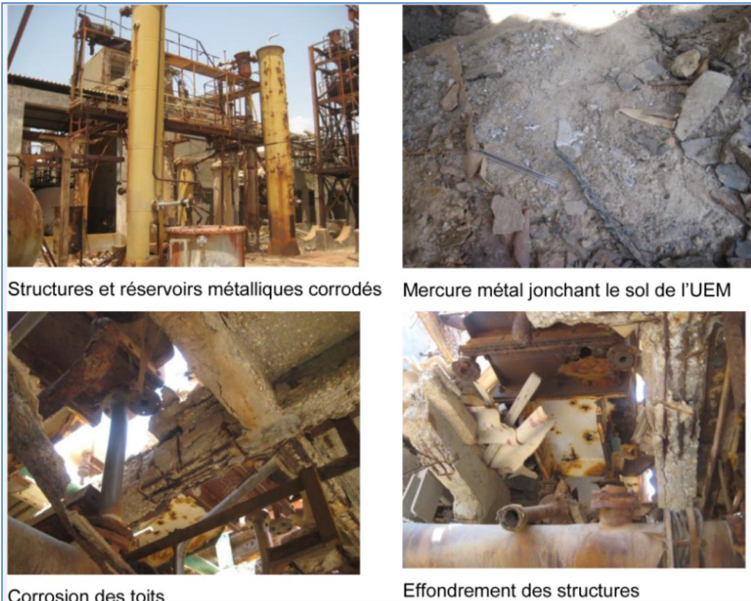
Photographies illustrant le collapse de l'UEM en 2017 et accentuation de la pollution des sols.
