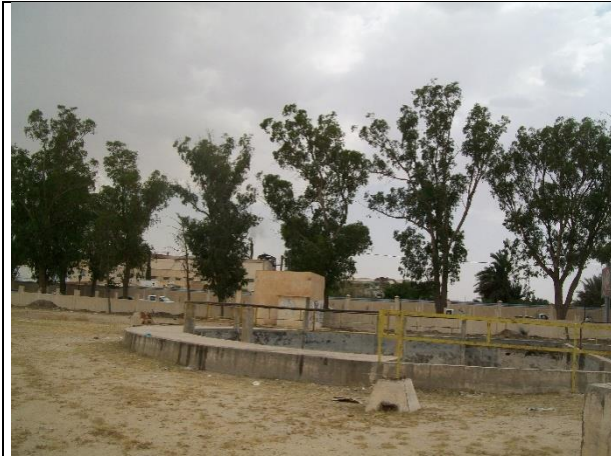
Site de Station d'Épuration polluée et abandonnée
